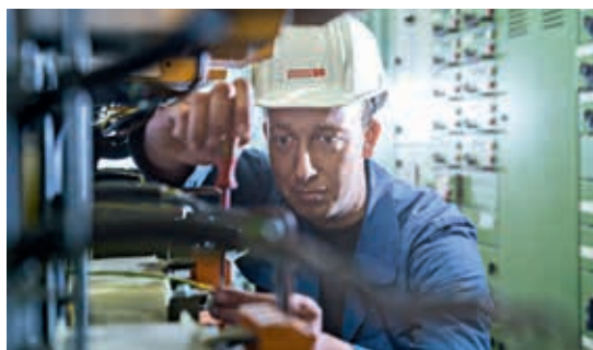
Komplexe Elektro-, Mess-, Steuerungs- und Regelungstechnik wird von uns installiert, geprüft, gewartet und repariert
